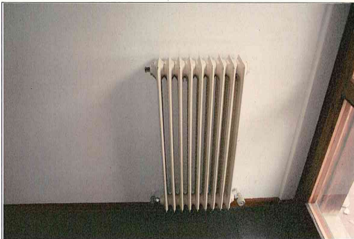
Particolare elemento radiante
