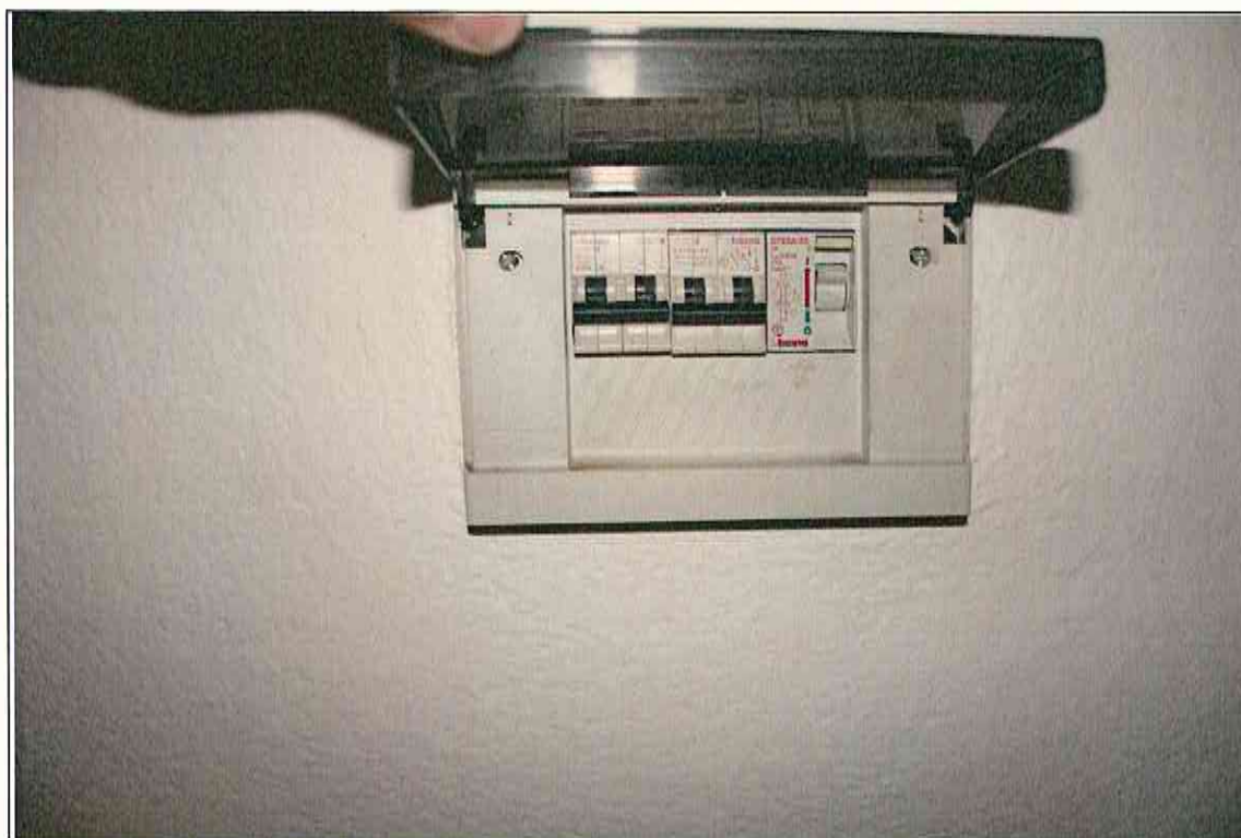
Particolare differenziale magnetotermico
