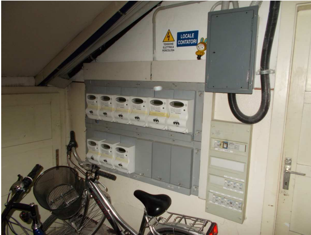
Quadro contatori sottoscala a piano seminterrato.
