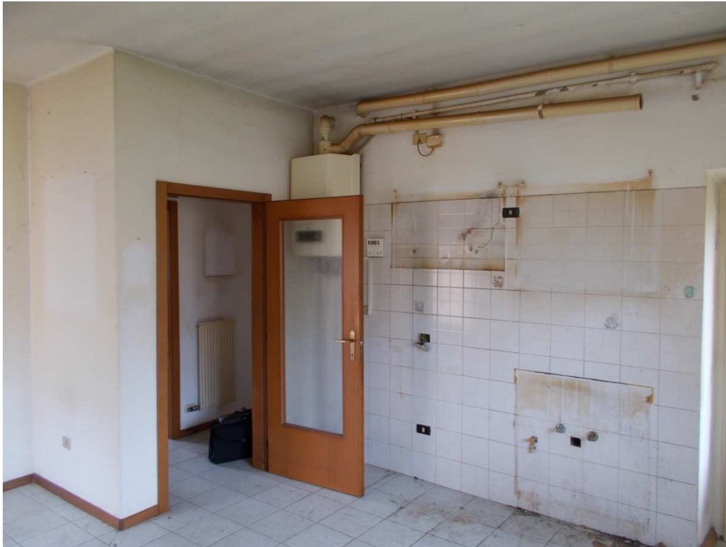
Vista zona cottura con caldaia murale.
