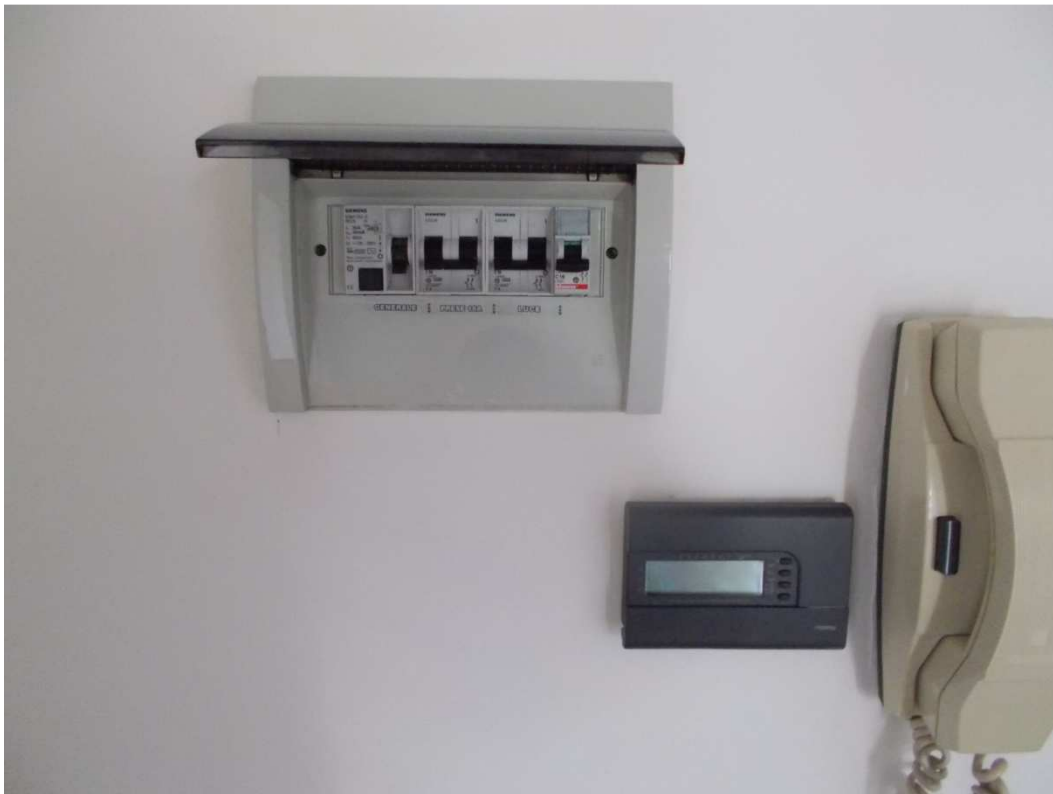
particolare quadro elettrico, cronotermostato, citofono
