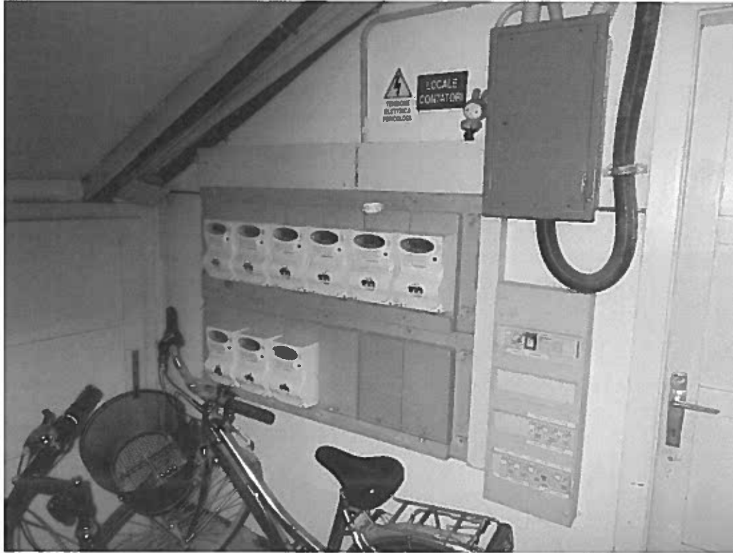
Quadro contatori sottoscala a piano seminterrato.
