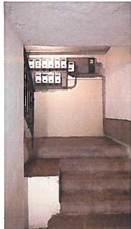
Contatori elettrici nel sottoscala
