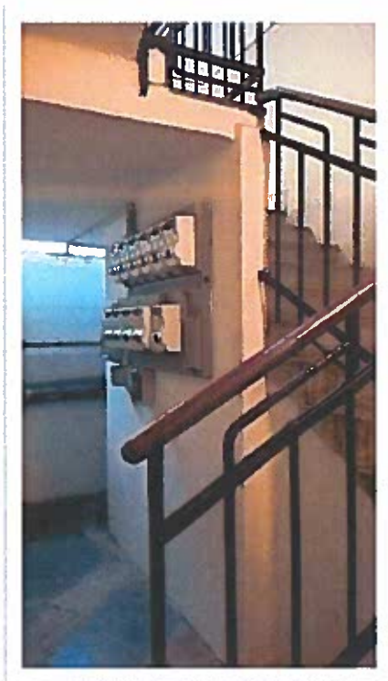
Contatori elettrici nel sottoscala
